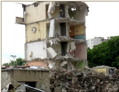
Les derniers jours des bâtiments Mont-Cindre et Mont-Gerbier. Photo Progrès/Monique DESGOUTTES ROUBY
